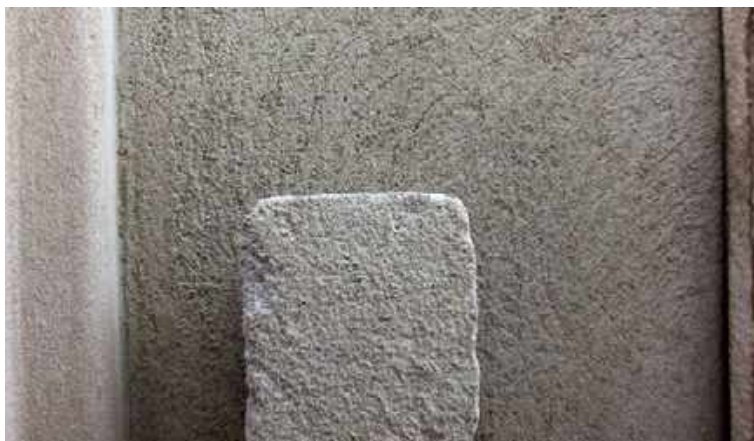
5. Próbką oryginalnego tynku i propozycja nowej zaprawy, próba odtworzenia sposobu zatarcia oraz frakcji kruszywa
