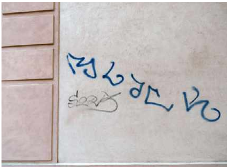
10. Staromiejska elewacja bezmyślnie zdewastowana przez wandali napisami graffiti tuż po zakończonych pracach konserwatorskich
